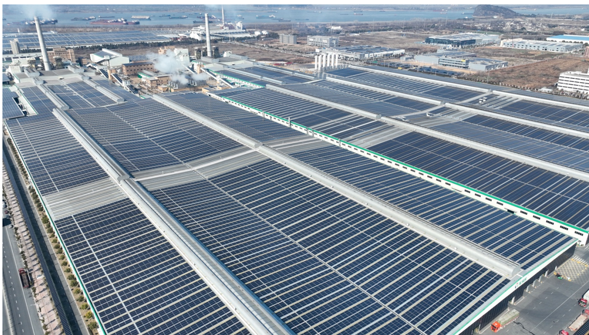
图 4-8 信义光能控股有限公司屋顶光伏 60
